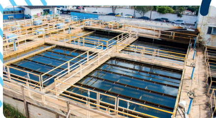
Estação de Tratamento de Água
